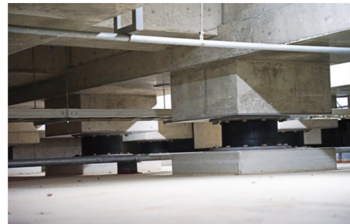
地階に備え付けられた免震構造
