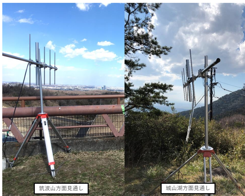
図 3 アンテナ設置環境
