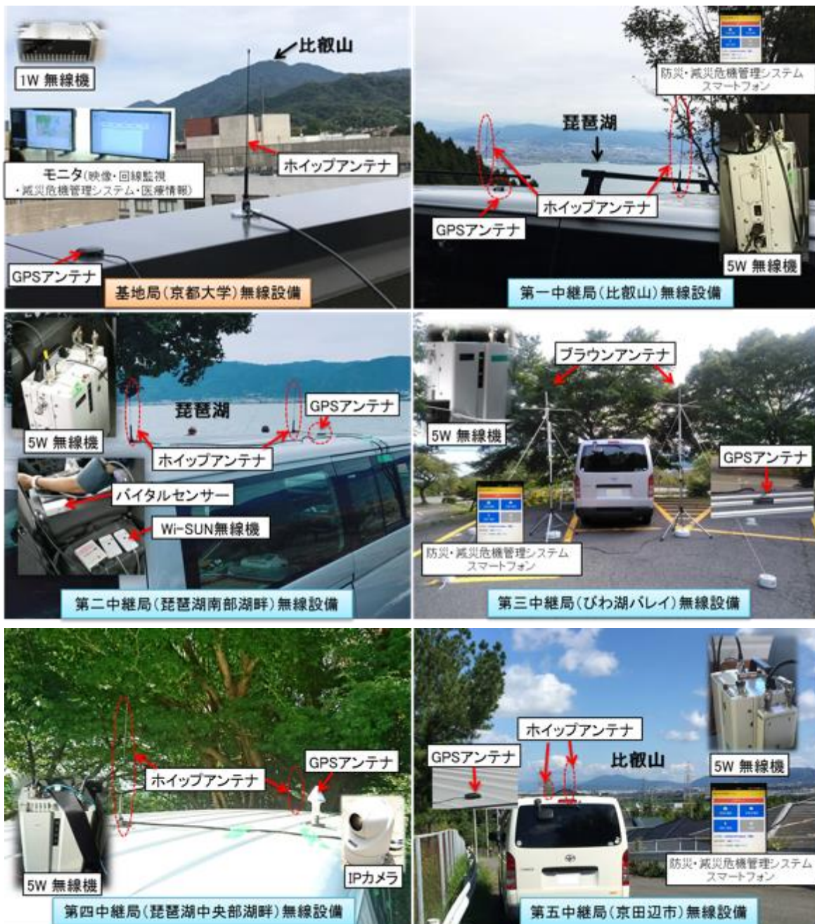
図4 無線局設備構成(各拠点には簡単なアンテナの装備で、拠点間の位置合わせを行わずに中継が可能)
