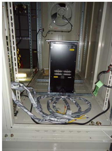
図2 三相電力ルータ設置写真
