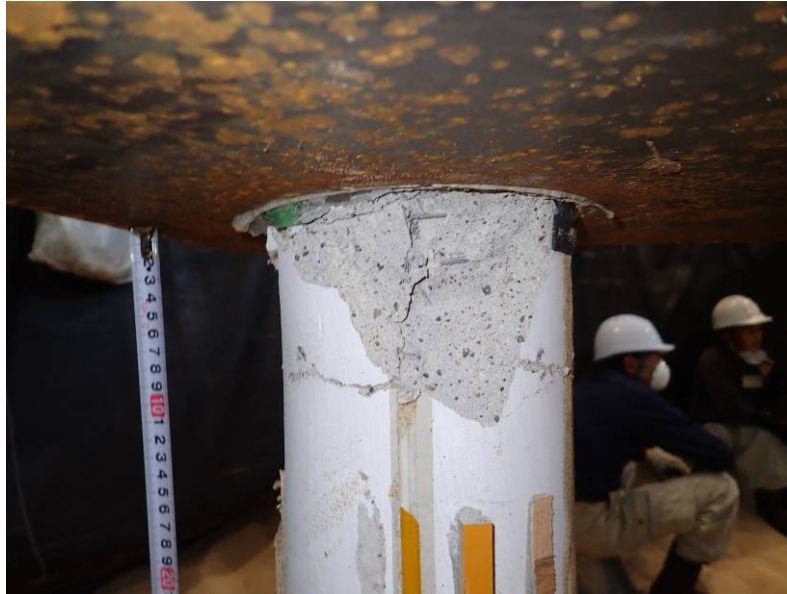
写真2 杭頭部のコンクリート剥落状況
