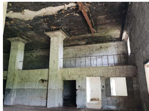
テナアン島の旧日本軍通信施設。蜂が多く、また建物の老朽化がひどく危険。
