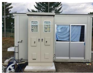
現場実験室および制御盤
