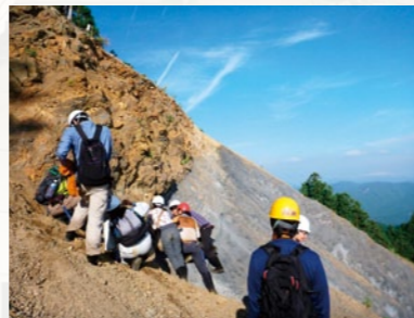
▲3年生向けの地質調査実習の様子。花崗岩(茶色)と結晶片岩(黒色)の境界を成す、日本最大級の断層「中央構造線」の変形構造を観察する。
